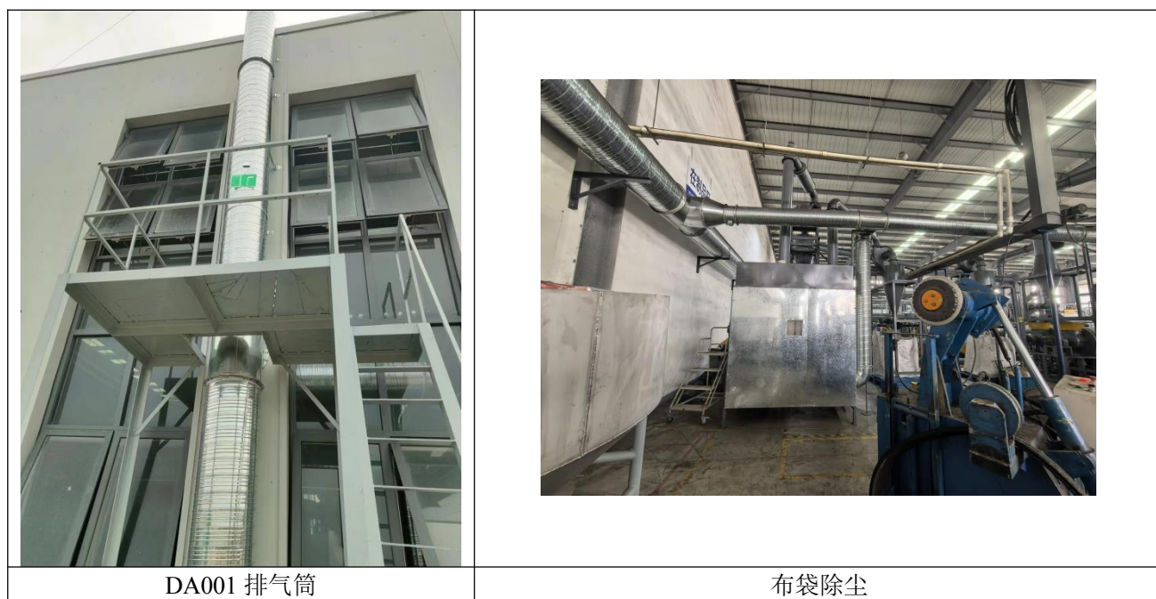
图 3-1 废气治理设施照片
